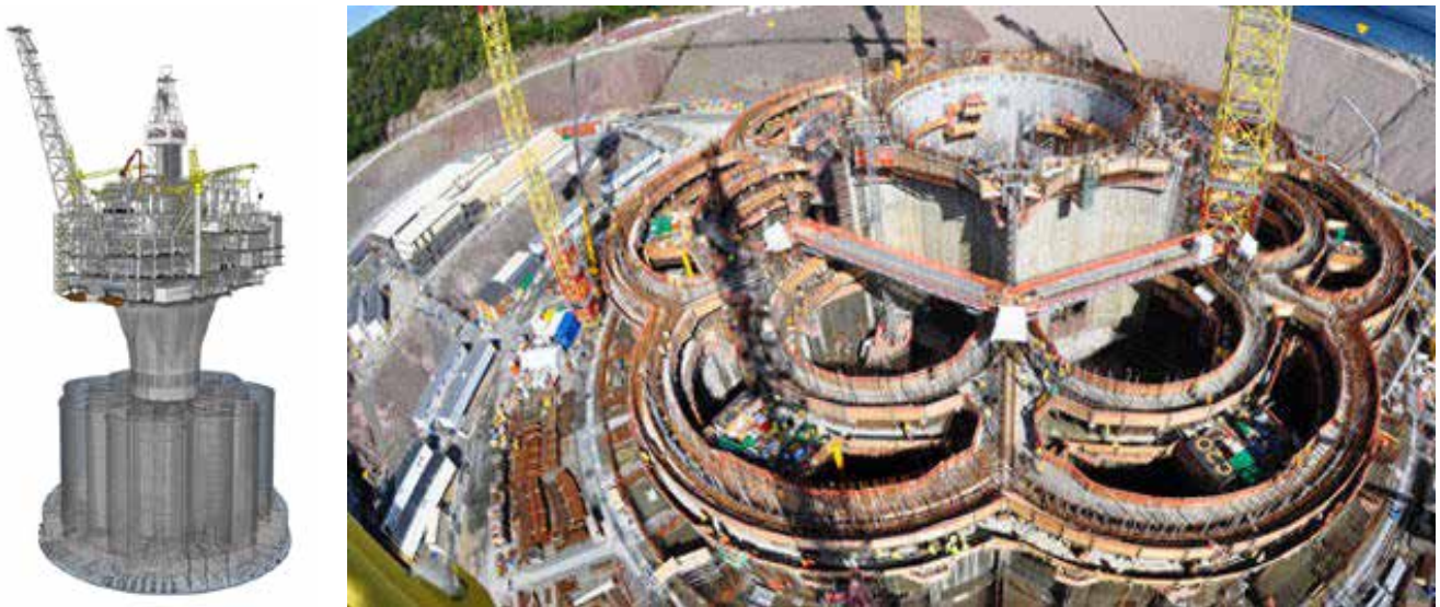
Figur 22. Hebron GBS. Bildet til høyre viser konstruksjon av understellet på Hebron (Kilde: Kværner).
