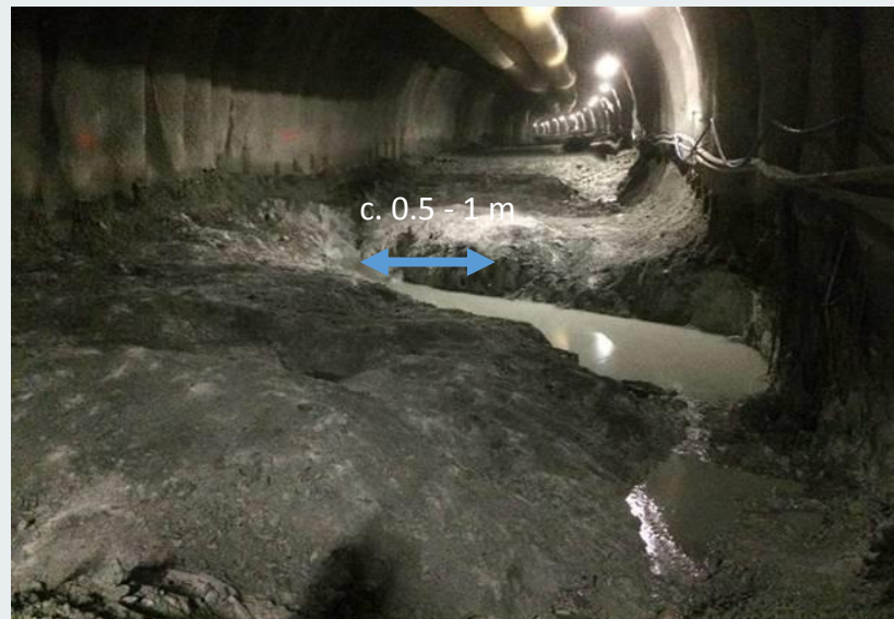
Foto: Terje Kirkeby: Svakesone i Folldalentunnel
