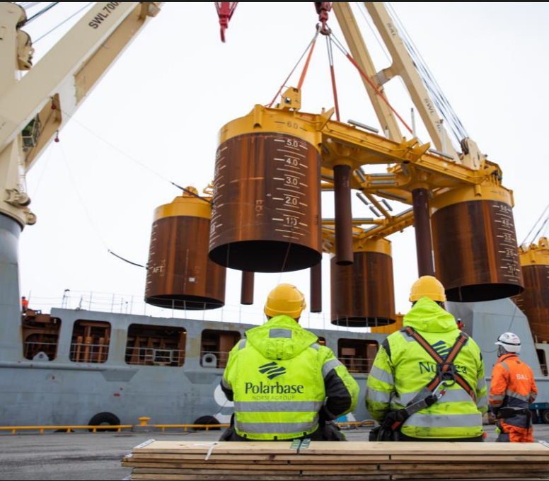
Foto: Gravås/Kleppa, Equinor
