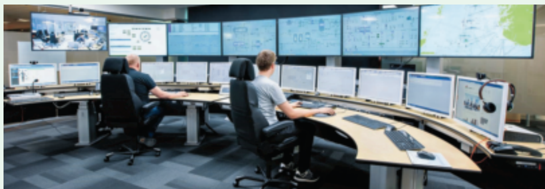
Figur 2.29 Kontrollrommet for Ivar Aasen. Foto: Aker BP
